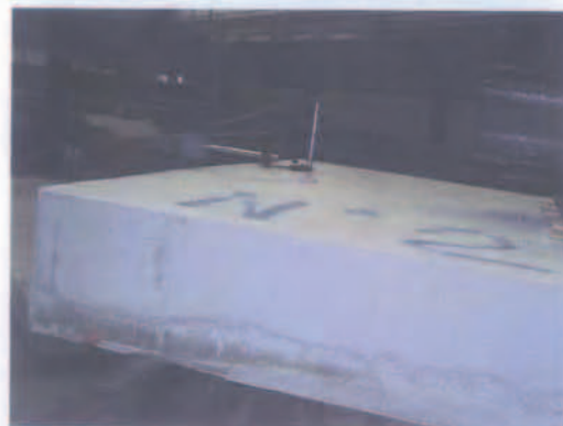
Fotografia 7: Rilievo dell'abbassamento dell'appoggio
