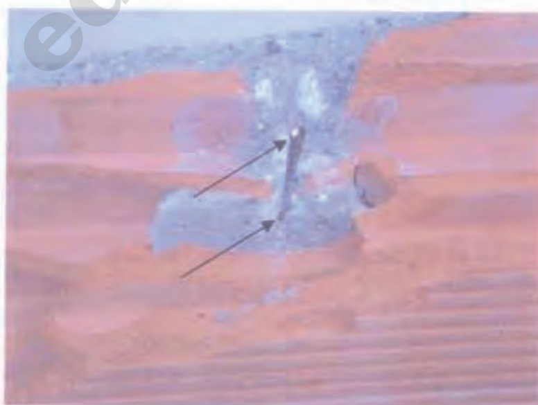
Figura 3. Riproduzione fotografica di un particolare di un campione di "Piastra in laterizio gettata, con armatura trasversale, 50x30x6 cm" visto in sezione. Le frecce evidenziano l'armatura trasversale metallica (diametro 3 mm).
